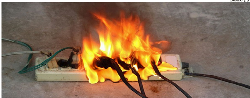
شکل ۵-۹. آتش‌سوزی در اثر استفاده از سه راهی
