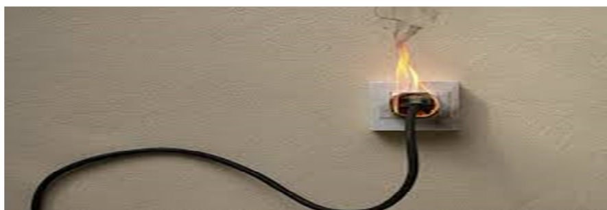
شکل ۵-۱۰: آتش‌سوزی در اثر فرسودگی پریز یا دوشاخه
