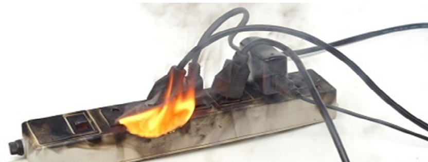
شکل ۵-۱۲. بروز اتصال کوتاه و آتش‌سوزی در اثر استفاده از سه راهی نامرغوب
