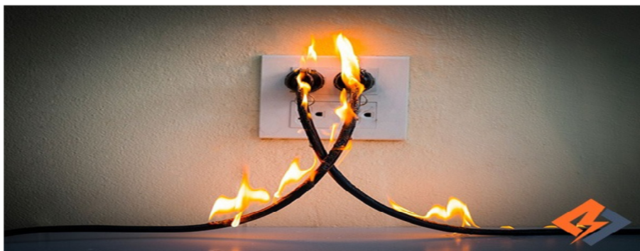
شکل ۵-۸. آتش‌سوزی در اثر بکارگیری سیم یا کابل نامرغوب و قدیمی
