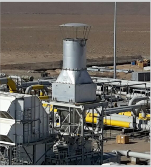
ایستگاه تقویت فشار صفاشهر
