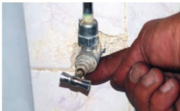
شکل ۱۴۷-۲- کنترل نشت آب از محل اتصال
